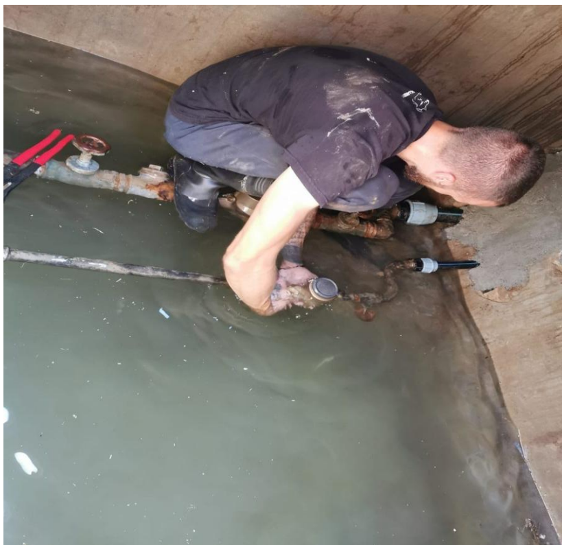
Slika 1. Terenska realnost: intervencija u vodomeru u potpuno poplavljenom šahtu. Čitač ne može da očita stanje; vodomer ostaje neočitavan. (foto: autor)
